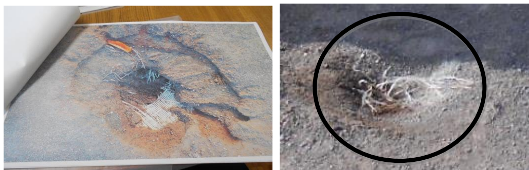
大雨後の運動場陥没時の写真
