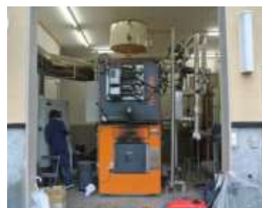
白樺荘 木質バイオマスボイラー
