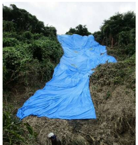
清水斎場敷地内における法面崩落の様子
