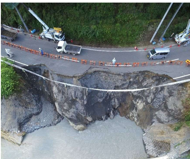
(主)梅ヶ島温泉昭和線の兼用護岸損傷の様子
