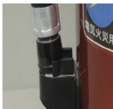
× 消火薬剤の漏れ
