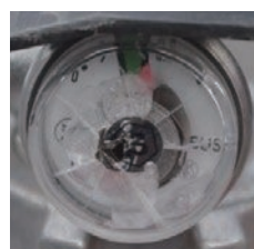
× 指示圧力計の損傷
