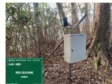
雨量計通信機設置
