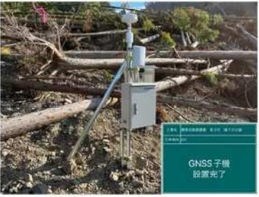
GNSS子機G-3 (23/10/27設置)
