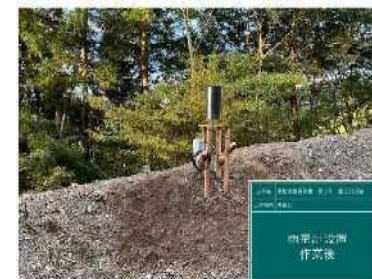
雨量計設置後
