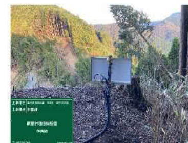
雨量計通信機設置
