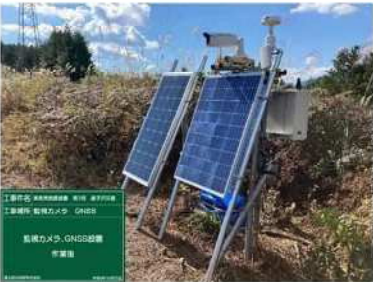
GNSS親機 (23/10/26設置)
