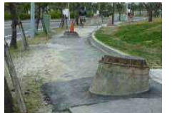
【マンホールの浮き上がり】
