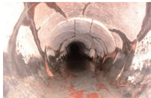
老朽化した下水道管の内部 クラック(ひび割れ)や破損は、道路陥没事故の原因にもなります。
