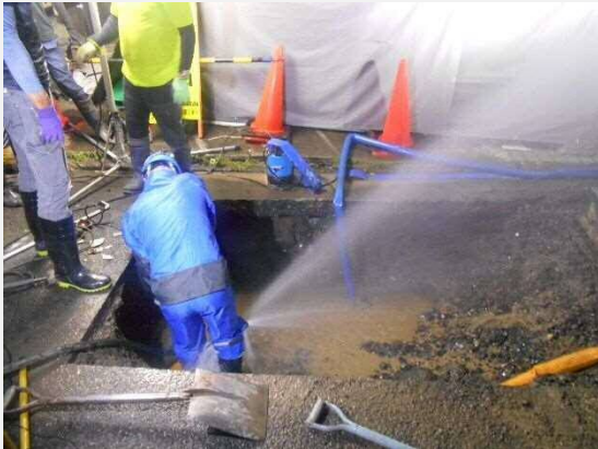
(写真3: 水道管漏水の様子)
