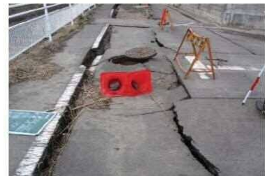
(写真3: 地震で被災した管による陥没)
