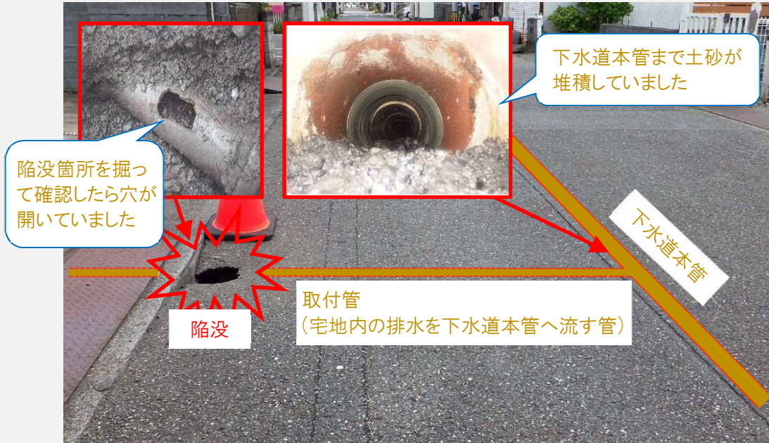
(写真5: 取付管破損による道路陥没)
