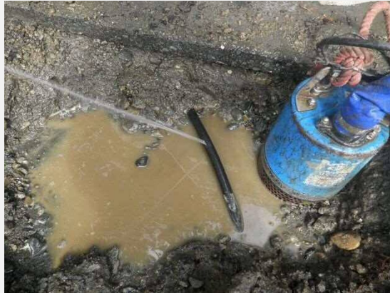
(写真4: 給水管漏水の様子)
