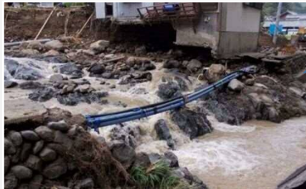
(写真2: 被災状況 清水区小河内地内(平成 26 年 10 月))
