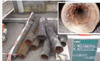
(写真4: 老朽化した水道管)
