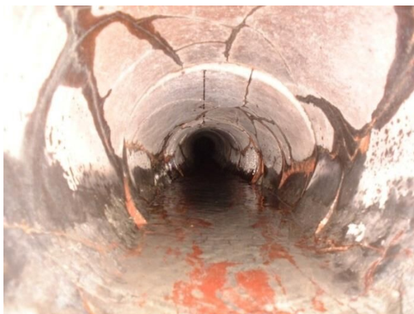
下水道管全体にクラック(ひび割れ)及び、破損が生じている様子
