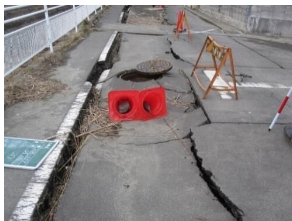
マンホール周辺の道路陥没状況
