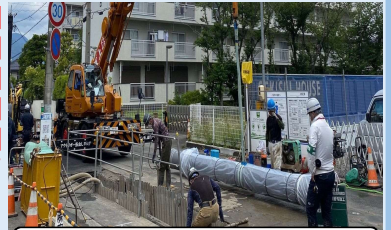
管の耐震化・老朽化対策
