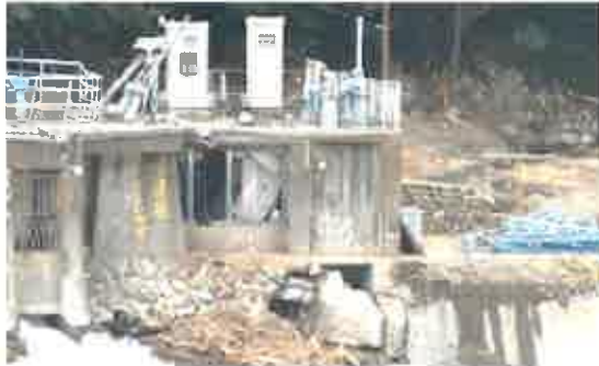
建具 流失・躯体 破壊
