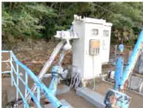
河川監視カメラ 制水扉 倒壊
