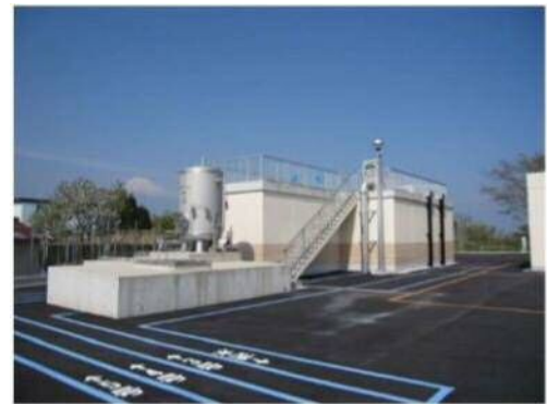
蒲原第3配水場
