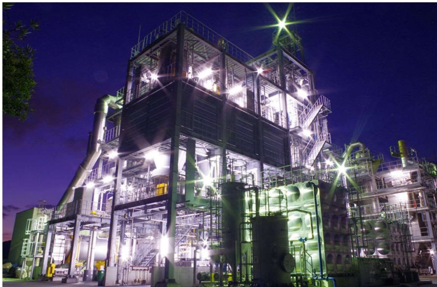
中島浄化センター汚泥燃料化施設
