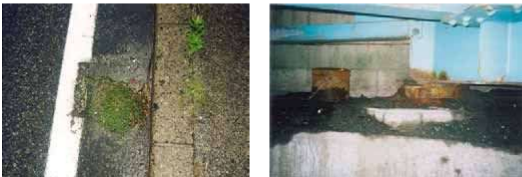
写真 5.1 (左) 排水柵の土砂詰まり (右) 沓座の土砂堆積
