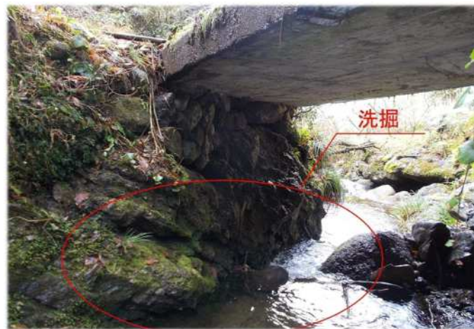
図 2.3 健全性Ⅰ→Ⅲに遷移した損傷例(無名橋 626:下部工《洗掘》)
