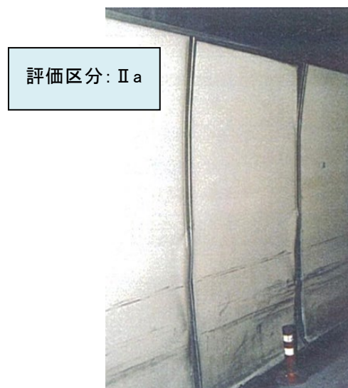
図 6-21 損傷例(内装板の変形)
