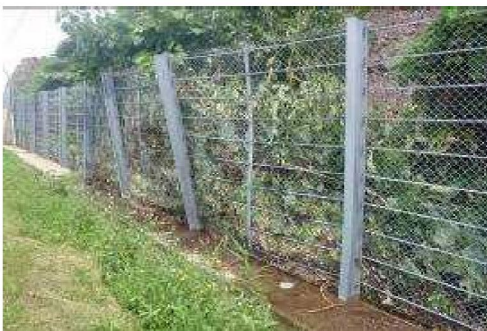
図 6-40 落石防護柵の傾動の例
