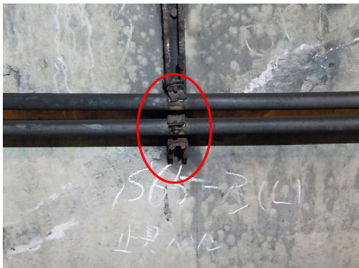
図 6-30 取付金具の腐食(Ⅲ判定)
