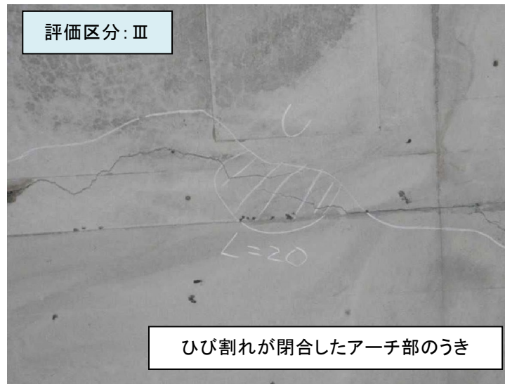
図 6-4 損傷例(覆工:うき・はく離・はく落):大原丸秀トンネル SP13
