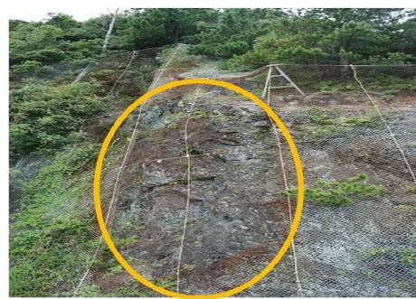
図 6-41 落石防護柵の断面欠損の例
