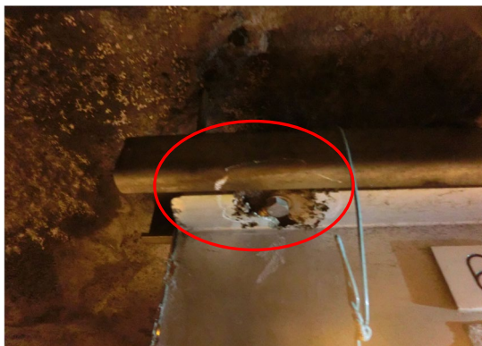
図 6-25 腐食による本体の断面欠損(Ⅲ判定)
