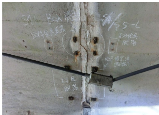
図 6-34 取付金具の脱落(Ⅲ判定)
