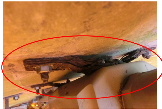
図 6-31 取付金具腐食によるボックス落下の可能性
