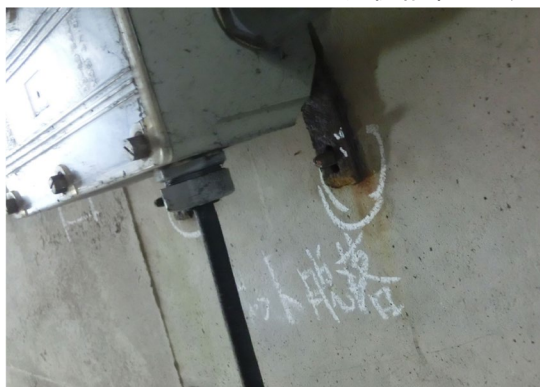
図 6-33 ナットの脱落(Ⅲ判定)
