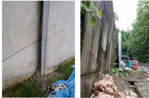
図 6-39 土砂のこぼれ出し、壁面の傾斜の例
