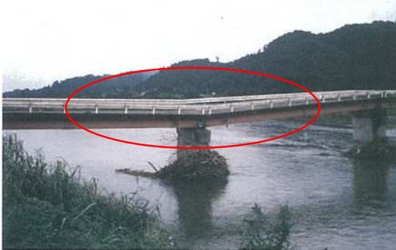
橋脚の沈下による通りの異常例
