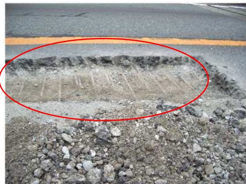
床版上面の土砂化の例
