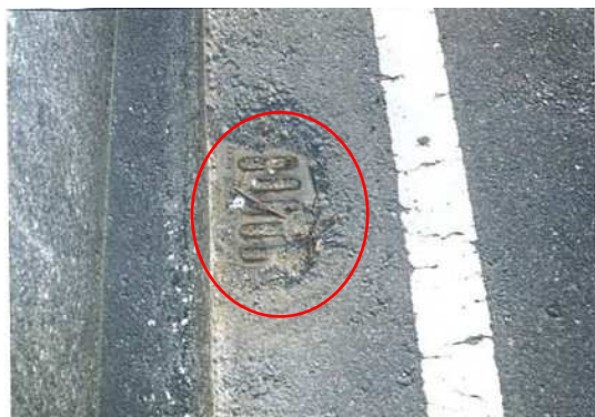
排水柵に土砂詰りが生じた例
