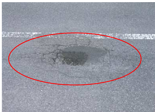
舗装のポットホールの例
