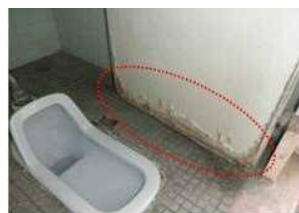
写真2：ドアの損傷・腐食
