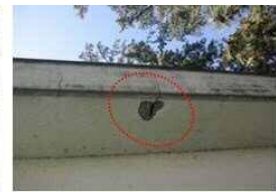
写真4：軒裏（鉄筋露出）
