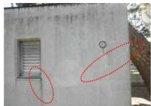
写真5：壁面のひび割れ
