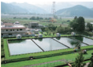
浄水場 (葵区門屋)
