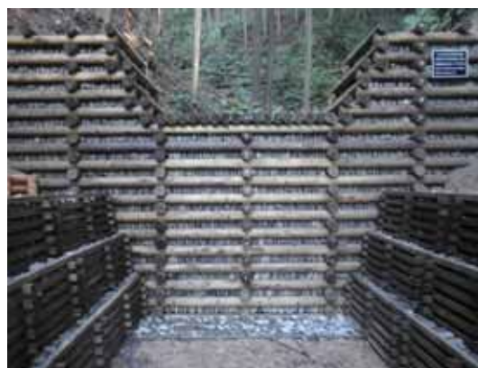
オクシズ産材を利用した木製治山施設
