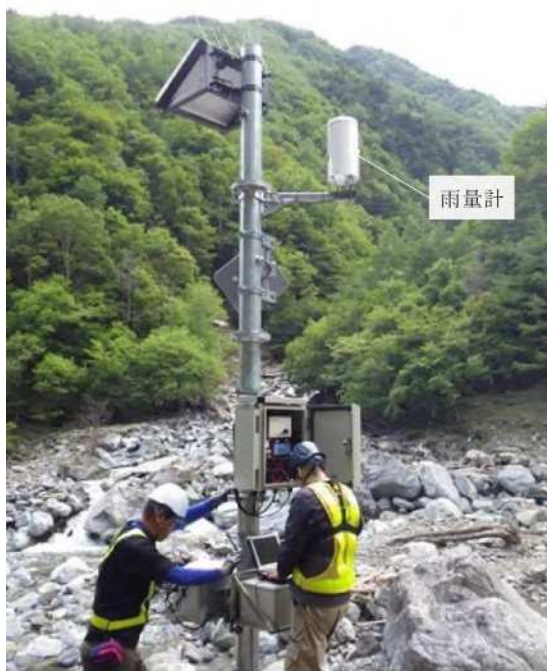
常時監視カメラ、雨量計の設置
