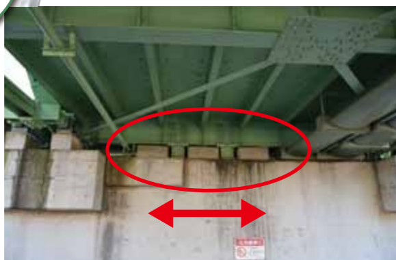
落橋防止システム
