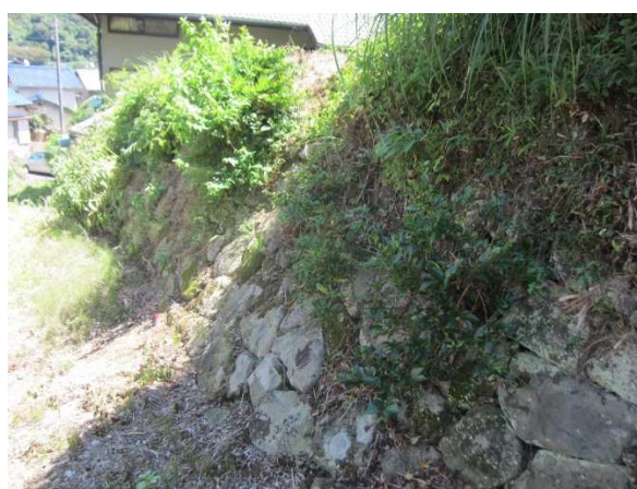
⑫ 第2郭北西の通路脇の孕みがみられる石垣
