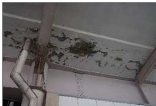
天井からの雨漏り (コンクリートの亀裂)
