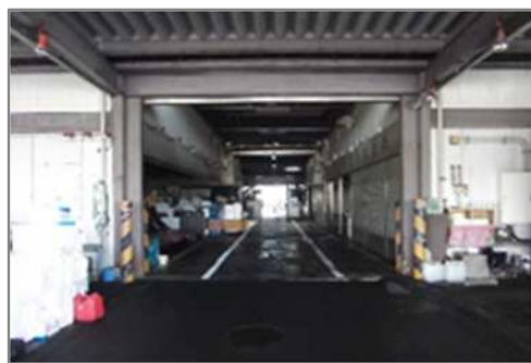
外部から小動物の侵入による商品の汚損
