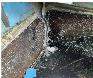
浄水場沈澱池の躯体ひび割れ
