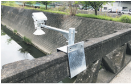
設置された水位計(イメージ)
