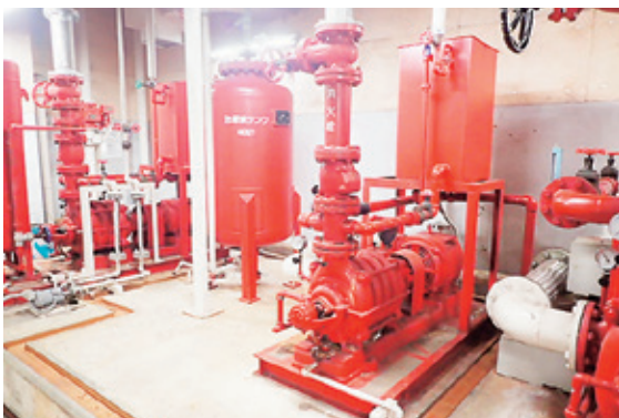
静岡庁舎の泡消火設備
