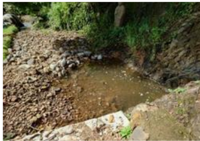
臨濟寺庭園土砂流出の様子
