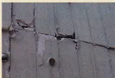
外壁(仕上材)の損傷
