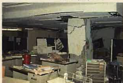
建物骨組の損傷 (写真提供・神戸市)
