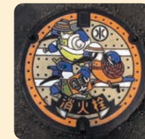
しょう か せん 消火栓
