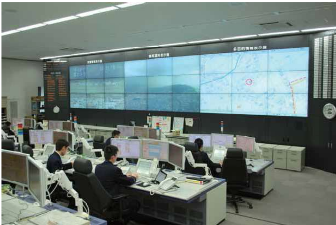
消防総合情報システム
