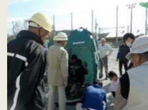
簡易トイレ の設置
