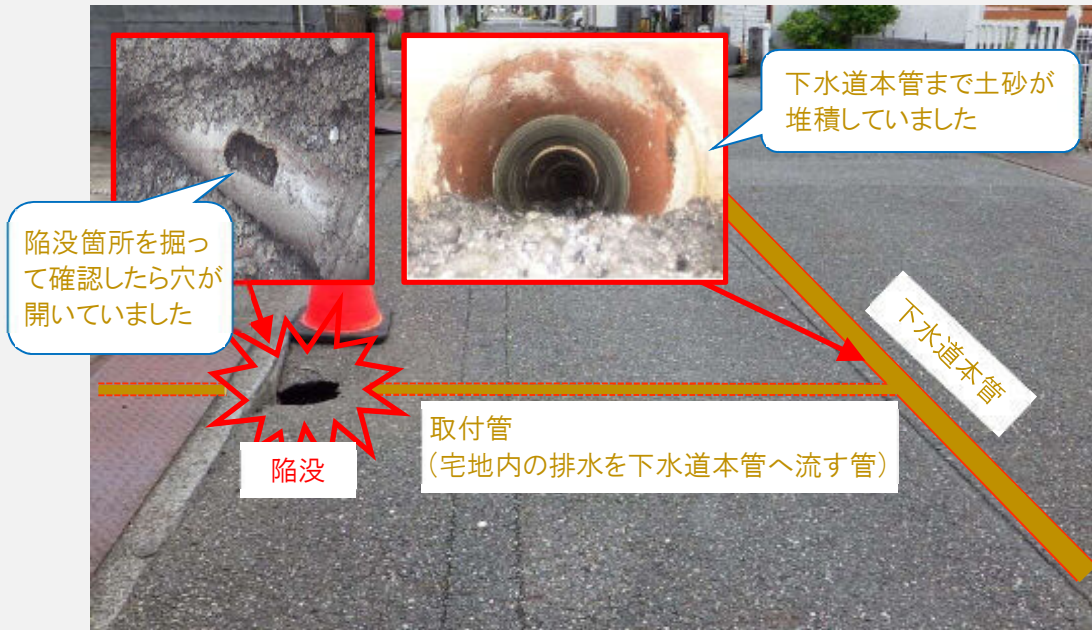
(写真5: 取付管破損による道路陥没)
