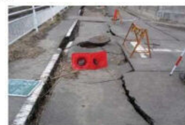
(写真3: 地震で被災した管による陥没)
