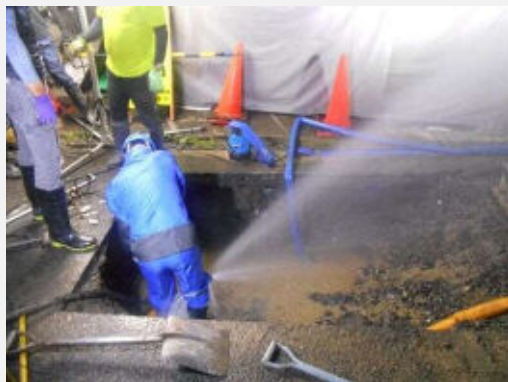
(写真3: 水道管漏水の様子)
