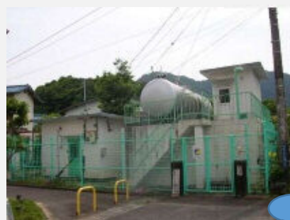
(写真2: 小規模な加圧施設)
