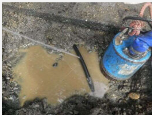
(写真4: 給水管漏水の様子)
