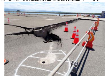
八代港における液状化被害
