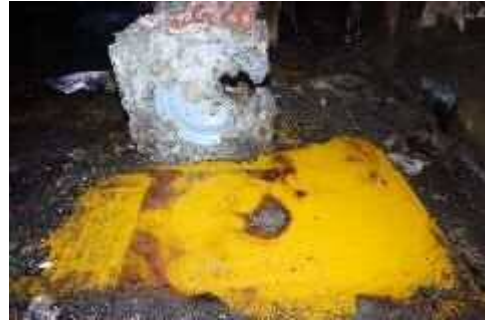
写真 41 出火箇所床面の状況
