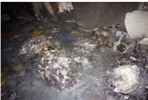
写真 38 火点室内の状況
