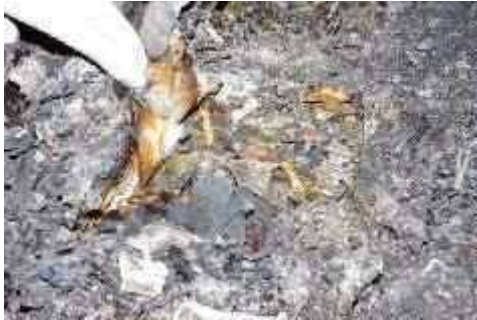
写真 40 出火箇所の状況
