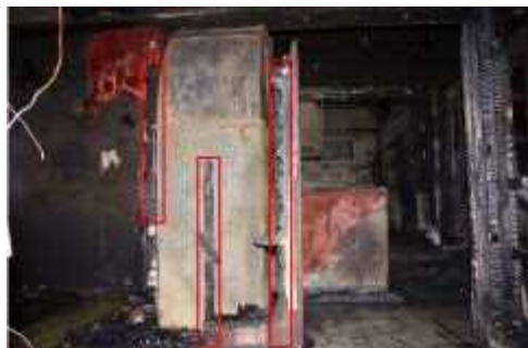
写真47 ダクトを囲む壁面の焼損状況
