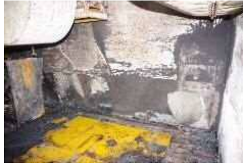
写真 37 南面の焼損状況
