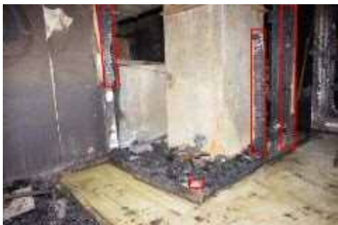
写真46 ダクトを囲む壁面の焼損状況
