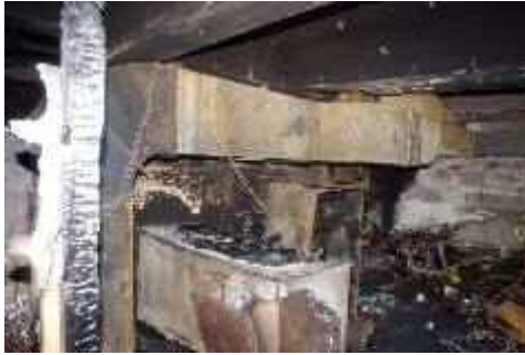
写真 36 ダクトの焼損状況
