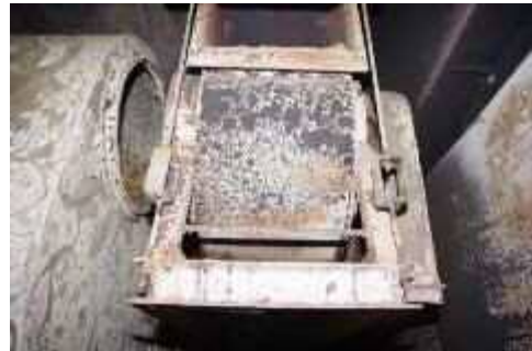
写真45 ダクト繋ぎ目部分の状況
