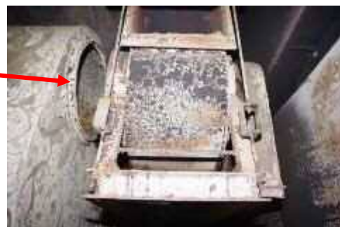
写真 62 ダクト繋ぎ目部分の空気流入箇所
