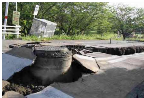
道路の液状化
