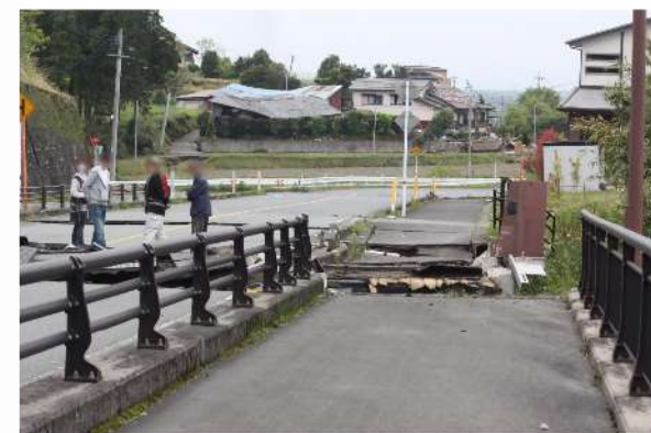
道路や橋の崩落
