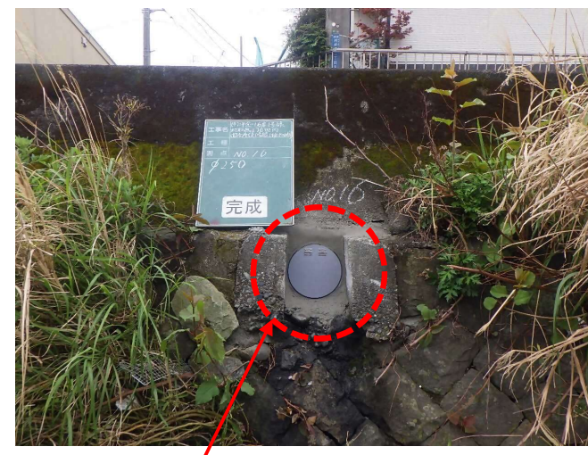
逆流防止施設
