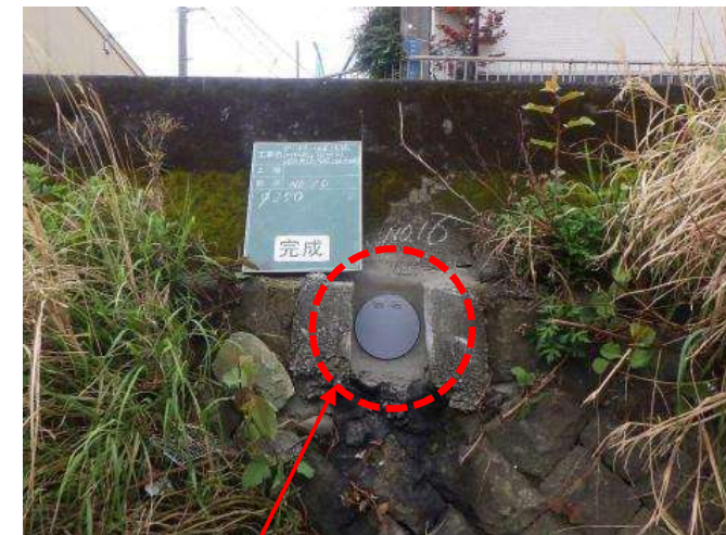
逆流防止施設
