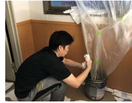
大雨の度に浸水 配管からの漏水も頻発
