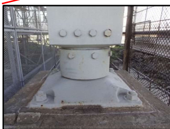
（長沼大橋の老朽化 及びロッキング橋脚）
