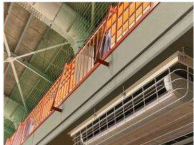
体育館空調設備(参考例)
