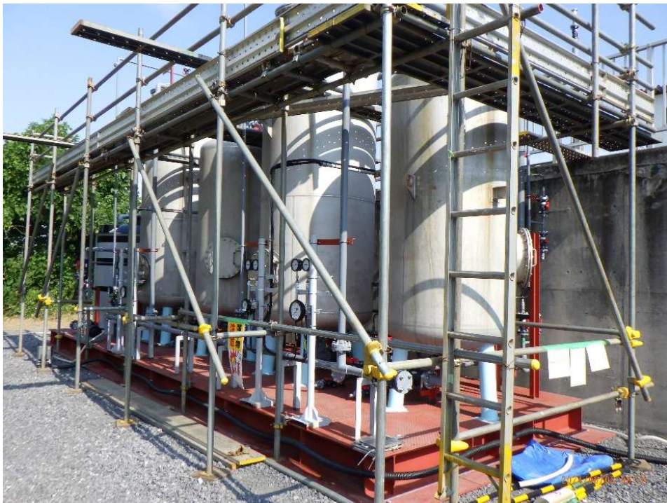
中型活性炭塔(1基：360t／日×2基) (2基合計：720t／日 処理可能)
