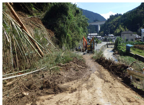
写真② (台風による主要道路の被災状況)
