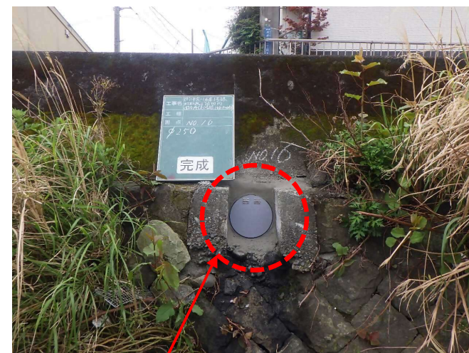
逆流防止施設
