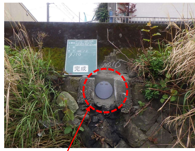
逆流防止施設
