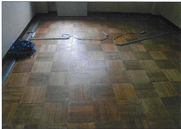
箇所: コンピューター室 床
