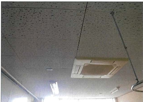
箇所: 保健室 天井
