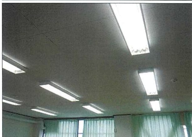
箇所: 普通教室(5・6年) 天井
