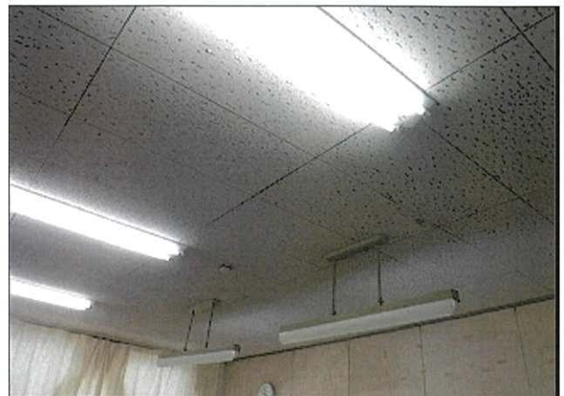
箇所: 普通教室(2年) 天井
