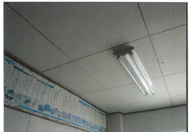
箇所：郷土資料室 天井
