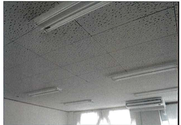
箇所: 多目的室 天井
