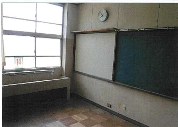
箇所：図工室 壁
