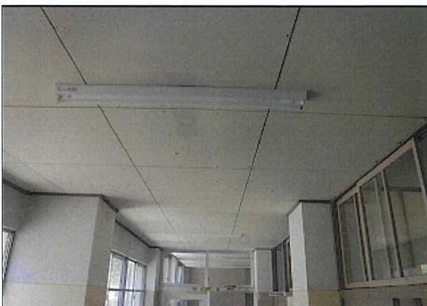
箇所: 廊下(1階~3階) 天井
