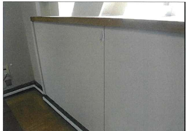
箇所：理科準備室 補強部 内壁 ケイ酸カルシウム板
