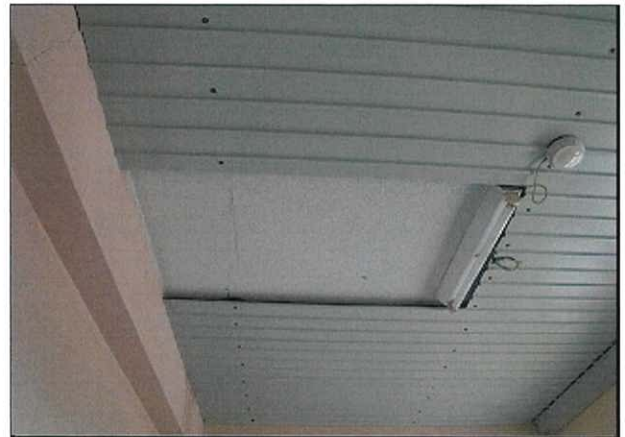
箇所: 3階 準備室 天井 折半板裏に吹付塗料
