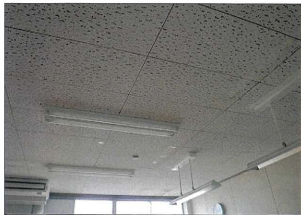
箇所: 普通教室(1年) 天井
