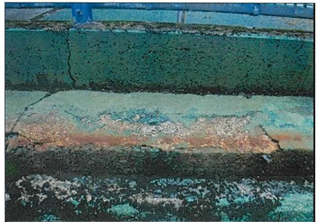
箇所: プール 外壁
