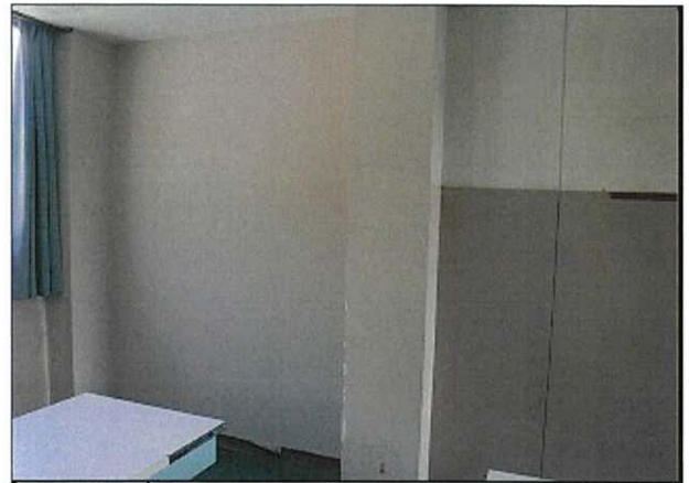
箇所：理科・家庭科室 壁 一部 石膏ボードあり
