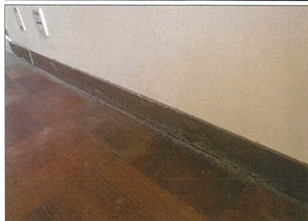
箇所: 保健室 床
