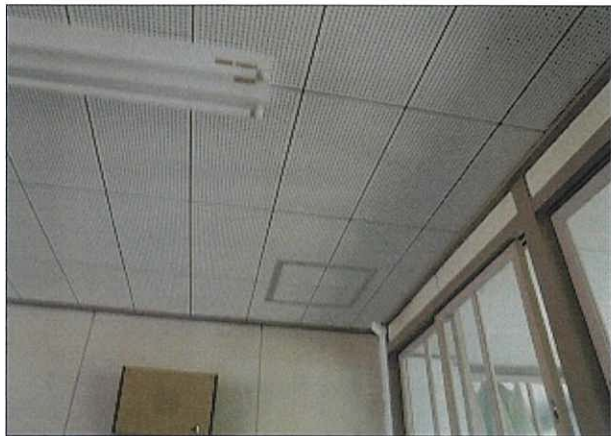
箇所：多目的室 天井
