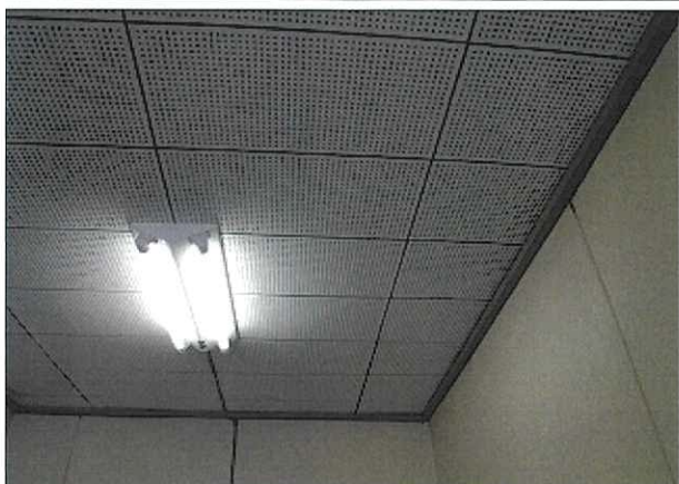
箇所：放送室 天井 吸音テックス
