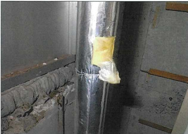
箇所: 郷土資料室 パイプスペース 配管被膜 グラスウール
