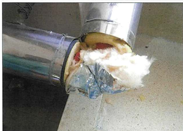
箇所：図工室 給水配管 グラスウール
