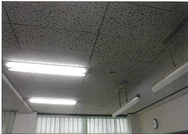
箇所: 図書室 天井
