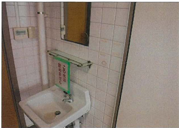
箇所: 校長室 内壁 タイル部
