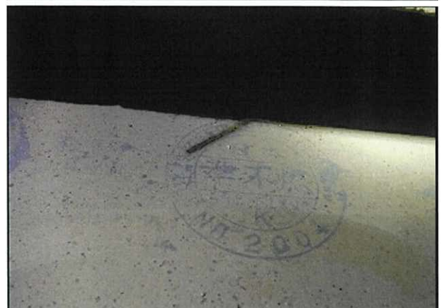
箇所: 廊下(1階~3階) 天井
