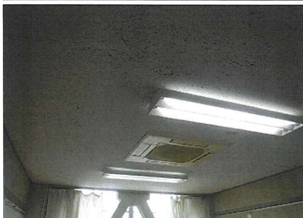
箇所：校長室 天井
