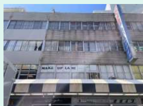
防災建築街区の老朽化
