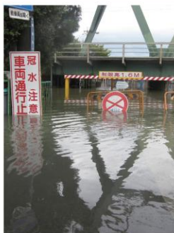
アンダーパス部の浸水被害 （2014年台風第18号 清水区銀座）
