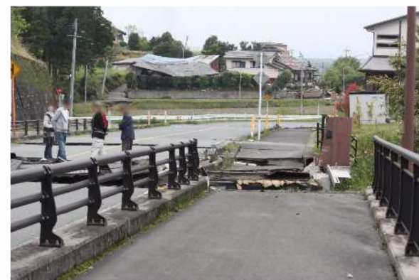
道路や橋の崩落
